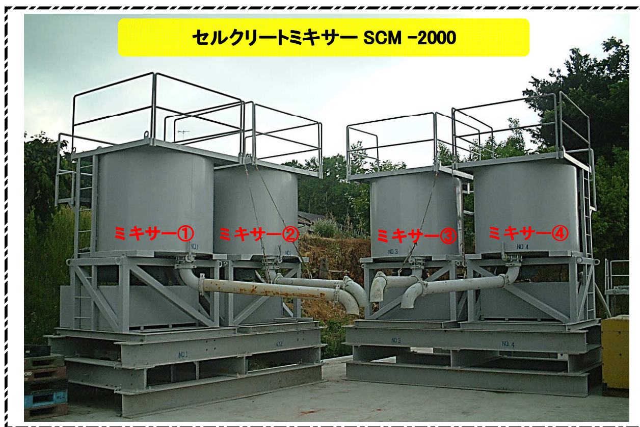
定置式プラント（2組設置）
