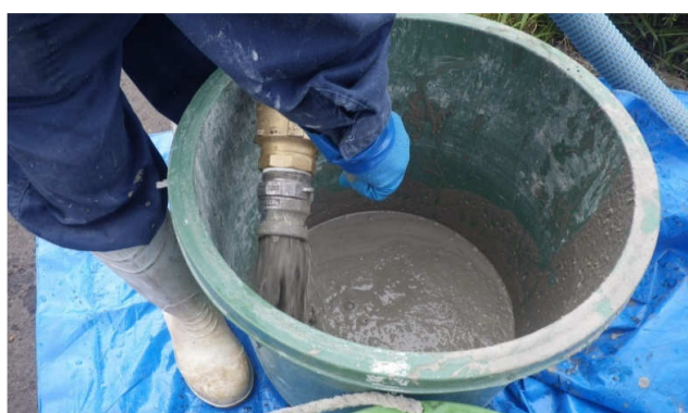
吐出口 吐出確認
