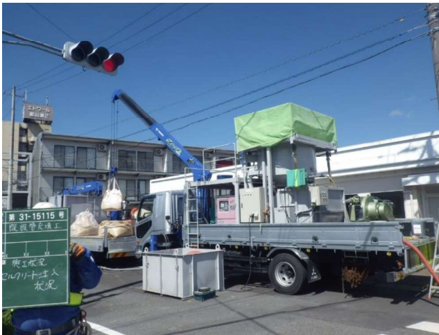
車上式プラントヤード
