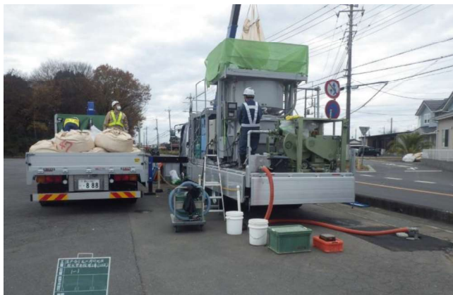
車上式プラントヤード
