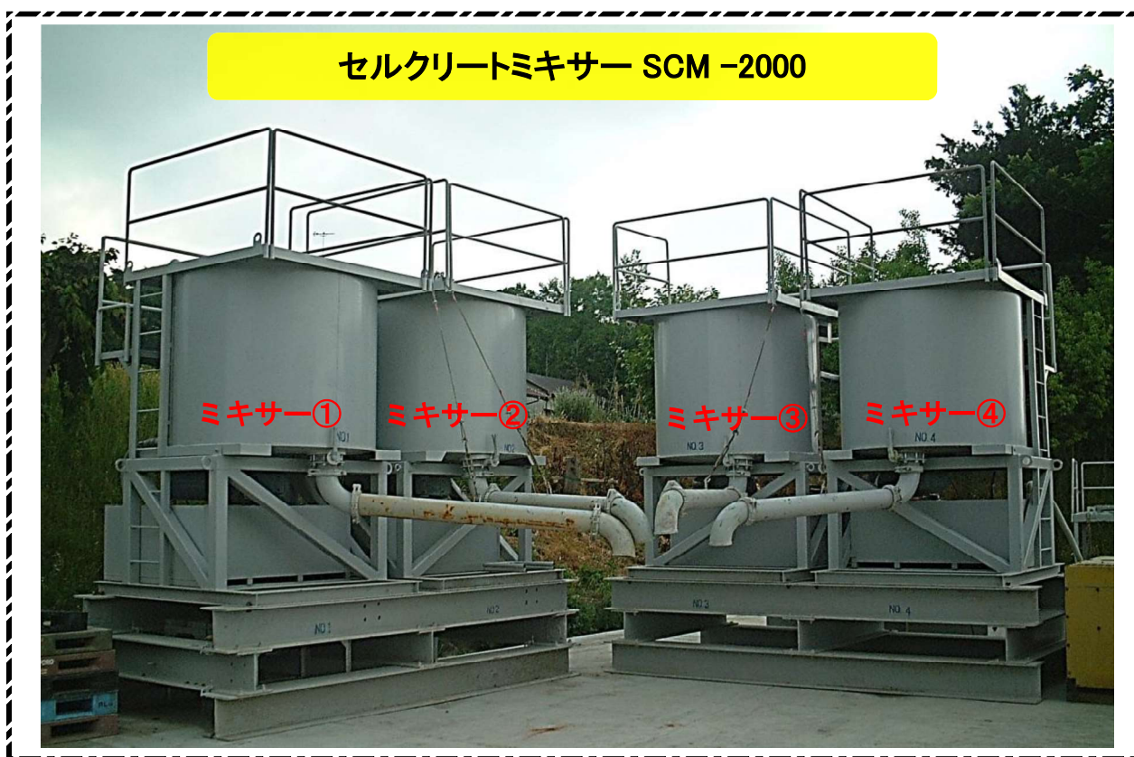
定置式プラント（2組設置）
