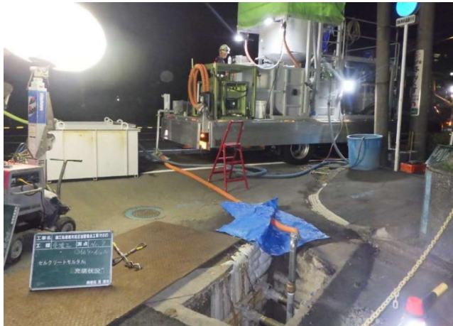
車上式プラントヤード
