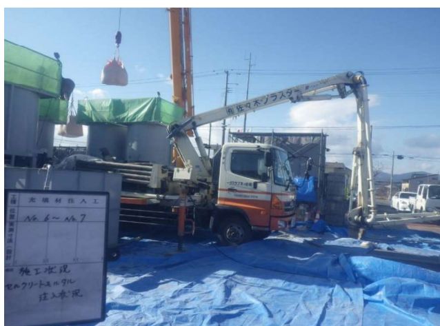
定置式プラント直接注入
