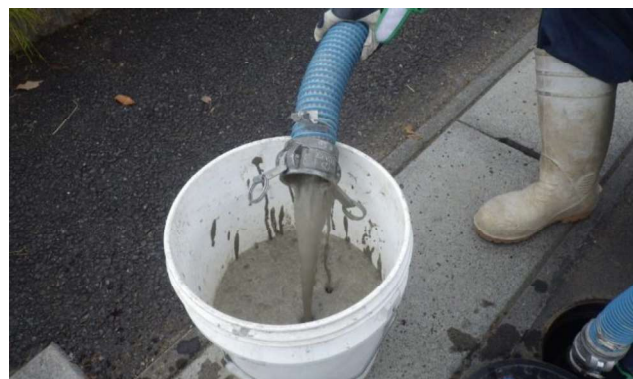
分水管① 吐出確認
