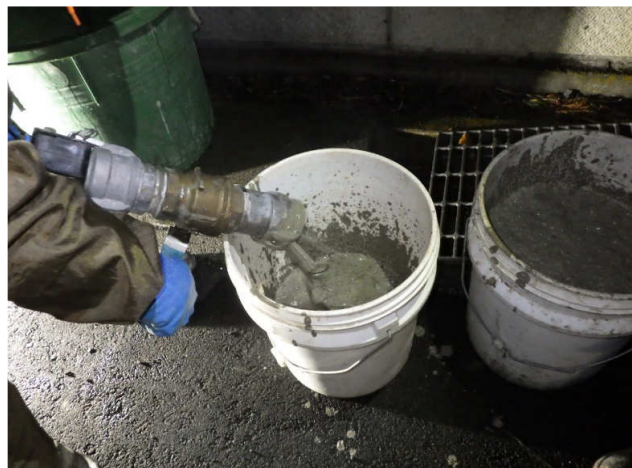
吐出口 吐出確認
