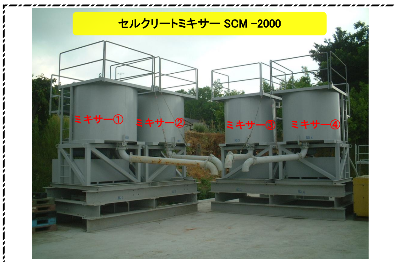
定置式プラント（2組設置）
