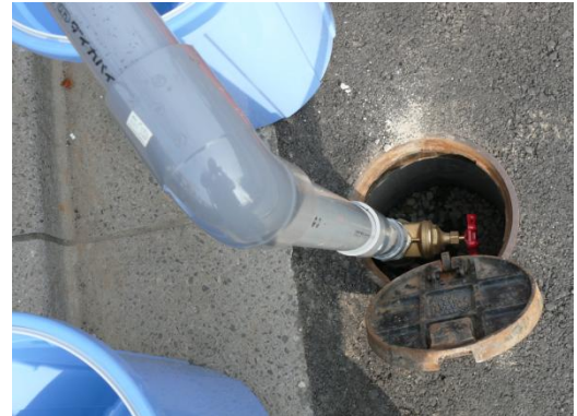
吐出管設置状況
