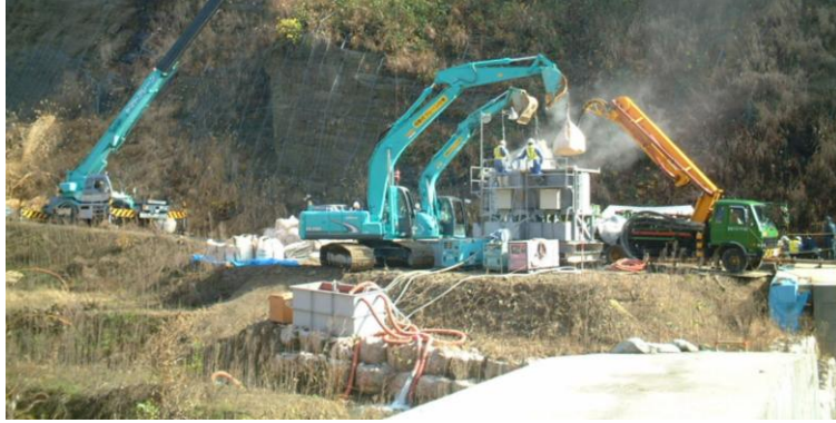
プラント基地の設備
